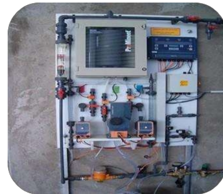
Equipo generador de dióxido de cloro.
