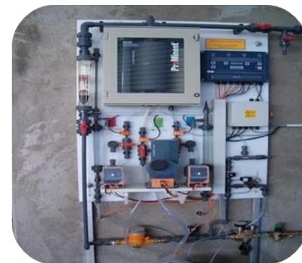
Echipament generator de dioxid de clor.
